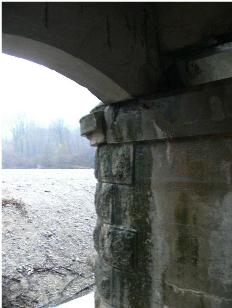
Vista della pila con evidenza della superficie in cemento e ferri affioranti sulla trave, dietro il deposito alluvionale.
